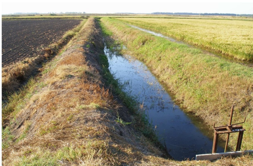
Рисунок 65 – Картовый оросительный канал с гидротехническими сооружениями
