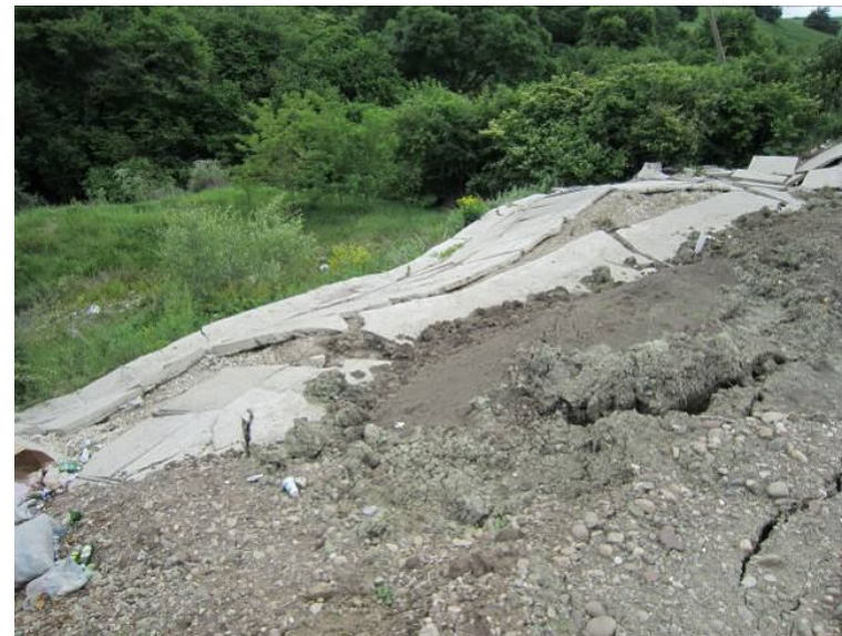
Рисунок 2.22 – Обрушение укрепленного откоса автомобильной дороги ст-ца Удобная – х. Зеленчук Мостовой, км 6+430–6+550
