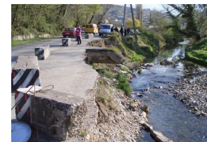
Рисунок 3.7 – Разрушенный оползнем участок дороги Веселое – Нижняя Шиловка, км 3+900
