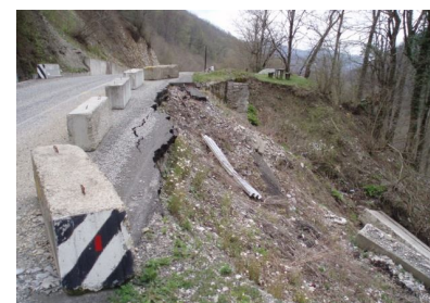
Рисунок 3.8 – Оползень на низовом склоне участка автомобильной дороги Макопсе – Наджиги, км 5+300
