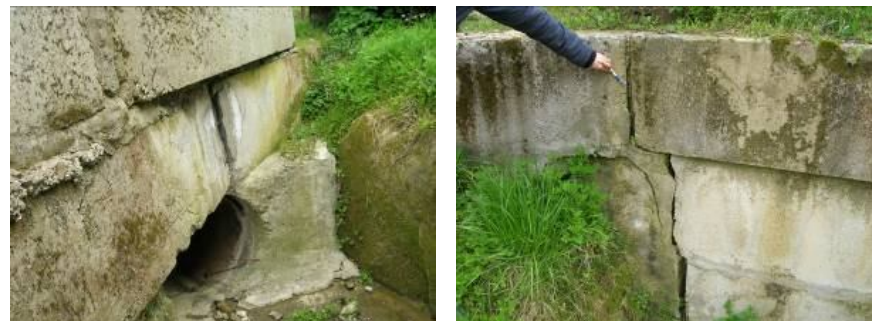
Рисунок 1.6 – Деформация конструкции водопропуска на участке автомобильной дороги Санаторий «Прогресс» – село Каштаны, км 2+750
