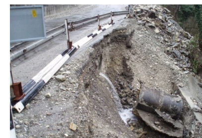
Рисунок 3.9 – Разрушение водопропускной трубы на автомобильной дороге Лазаревское – Кирова, км 3+600
