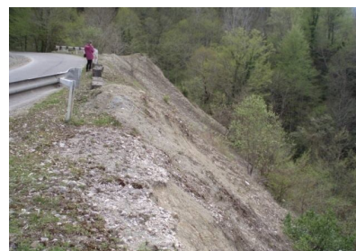
Рисунок 3.6 – Оползневой участок автомобильной дороги Подъезд к селу Красная Воля, км 1+100
