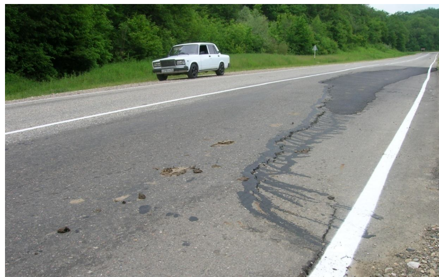
Рисунок 1.2 – Трещина отрыва на дорожном покрытии на км 32+535 автомобильной дороги Майкоп – Туапсе (2011 г.)
