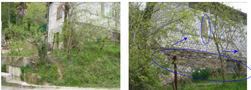
Рисунок 1.7 – Деформации жилого домовладения на верховом склоне участка автомобильной дороги Санаторий «Прогресс» – село Каштаны, км 2+750: заделанные трещины, свежая кирпичная и бутовая кладка
