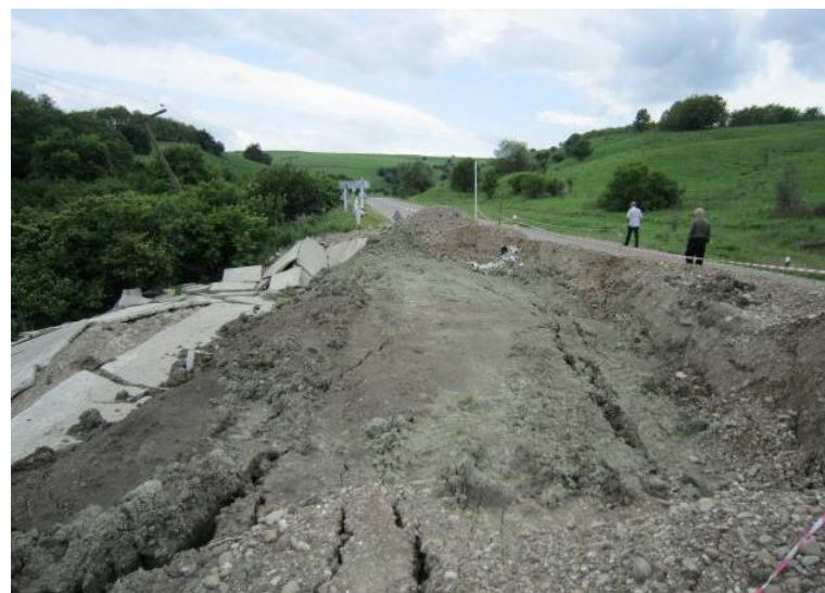
Рисунок 2.23 – Обрушение проезжей части автомобильной дороги ст-ца Удобная – х. Зеленчук Мостовой, км 6+430–6+550
