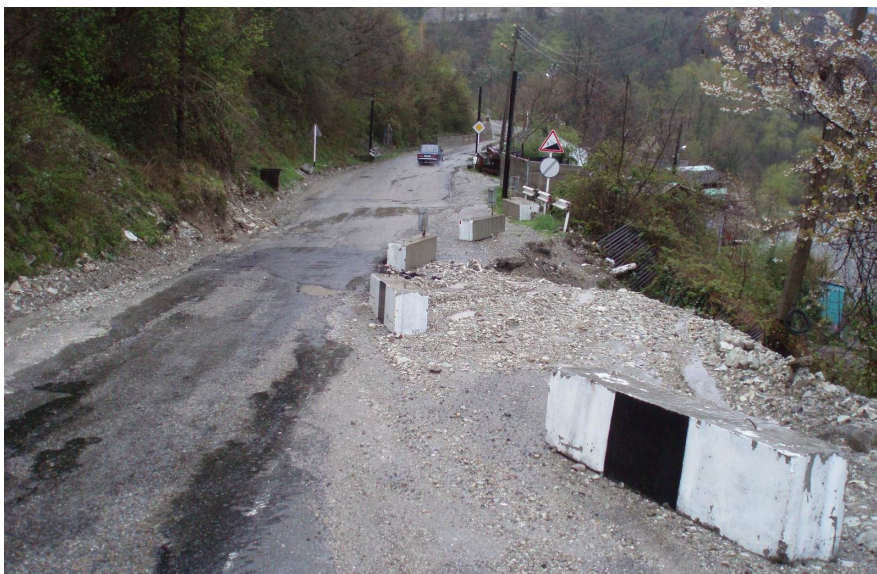
Рисунок 3.12 – Общий вид оползнеопасного участка автомобильной дороги с. Лазаревское – п. Кирова, км 2+800
