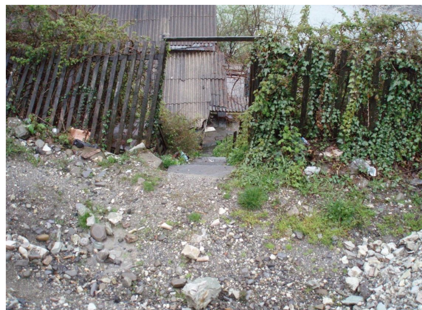
Рисунок 3.13 – Автомобильная дорога Лазаревское – Кирова, км 2+800: жилой дом, находящийся под угрозой разрушения действующим оползнем
