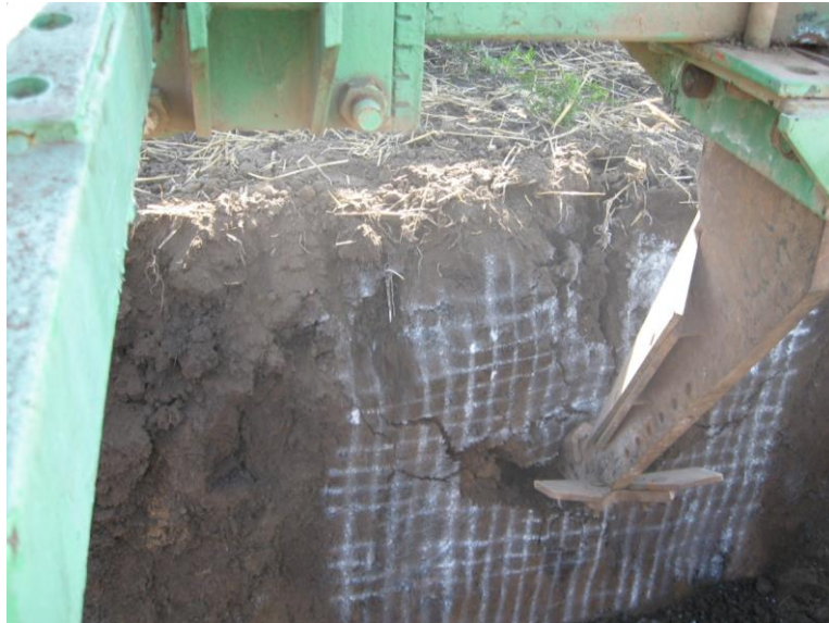
Рисунок 6.11 – Возникновение разрушающих деформаций от стойки ГРЗ
