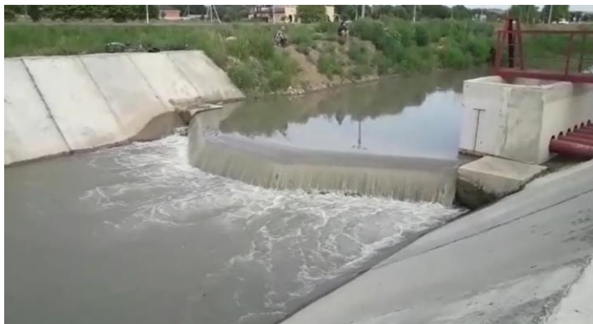
Рисунок 5.3 – Устройство водозабора у водоподпорного сооружения ООО «Южная плодоовощная компания» на Новокубанском канале
