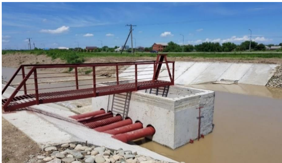
Рисунок 2.7 – Водозаборное сооружение ООО «Южная плодовоовощная компания» на Новокубанском канале (ВБ)
