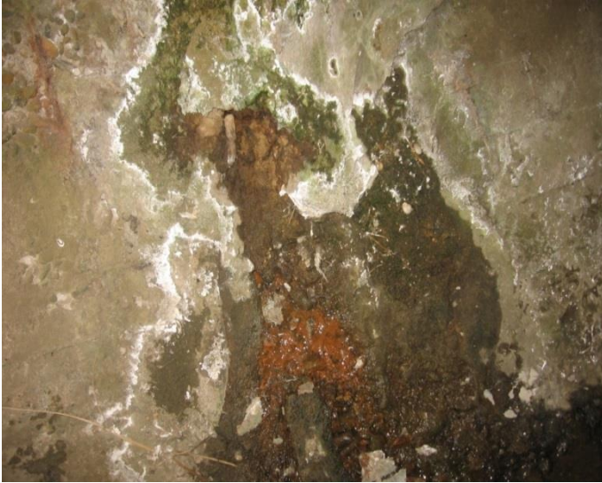
Рисунок 3.6 – Оголение арматуры и образование пустот в бетонном фрагменте ГТС, куда вследствие разрушения стыка между кольцами просачивается вода
