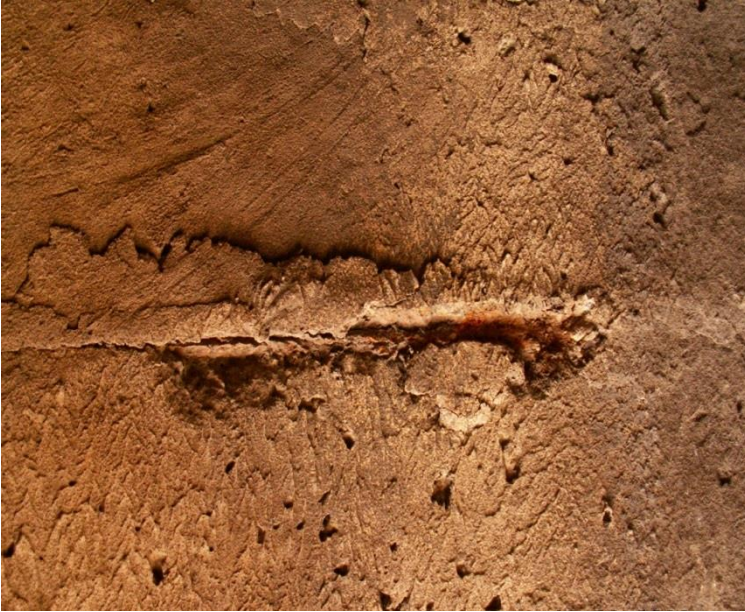
Рисунок 3.10 – Разрушение защитного слоя бетона
