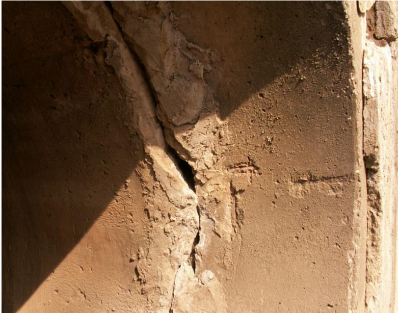
Рисунок 3.8 – Разрушение стыков конструкции
