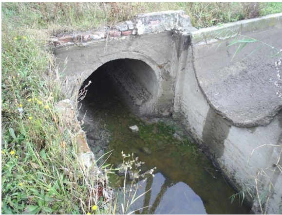
Рисунок 3.3 – Трубчатый водовыпуск подпитывающего сооружения Сх 6-3-1 Главного Афильского коллектора Афипской оросительной системы
