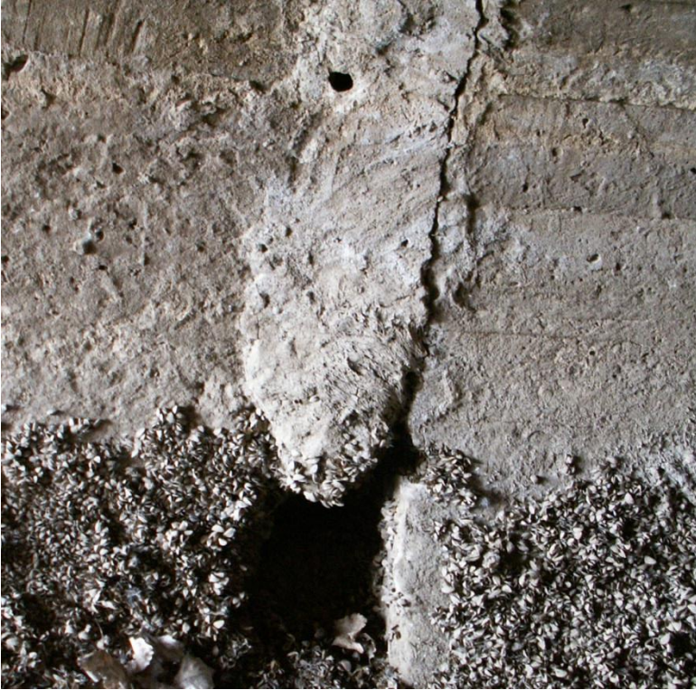
Рисунок 3.12 – Образование пустоты под кольцом и продольной трещины
