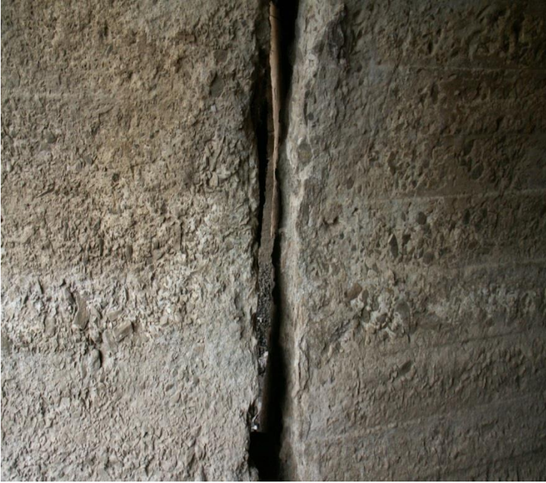
Рисунок 3.14 – Расхождение стыка между кольцами
