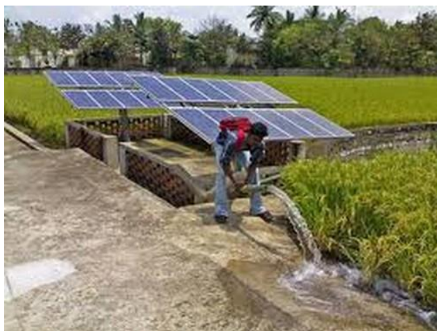
Рисунок 1 – Насос, работающий на солнечной батарее
