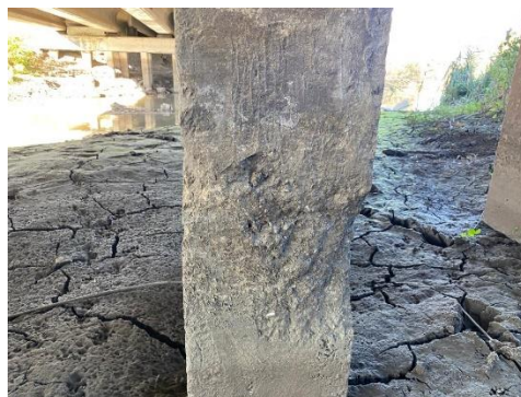
Рисунок 2 – Сколы и деформация опоры мостового переезда
