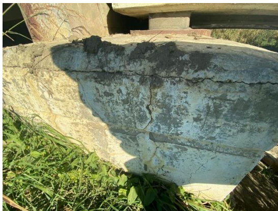
Рисунок 3 – Трещины в теле бетона опоры мостового переезда
